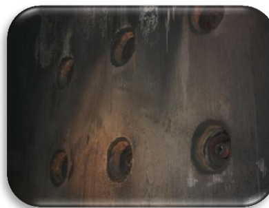
شماره (۱۰): مشعل‌های دیواره جلویی بویلر
