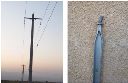
شکل ۱۵: عدم استحکام مناسب سر تیری مهره خور سیلیکونی استفاده شده
