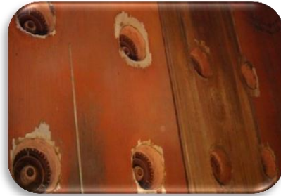
شکل (۱۱): مشعل‌های دیواره عقبی بویلر
