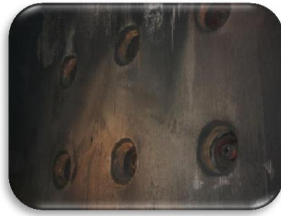
شماره (۱۰): مشعل‌های دیواره جلویی بویلر
